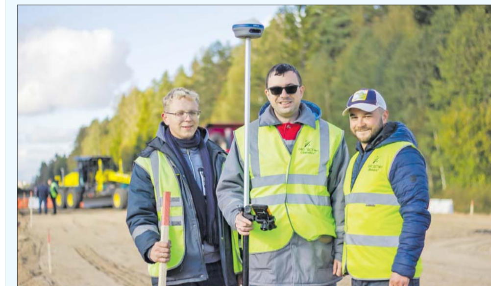
Геадэзіст Антон ДЗЯРКО, вядучы геадэзіст Аляксандр ТАРАСЕНКА і майстар Кірыл ГАЛІНОК займаюцца разбівачнымі работамі на 58-кіламетры ўчастку дарогі Р-46.
